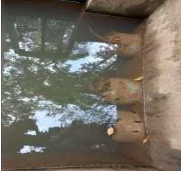
Gambar 1. Bak Penampungan Air
