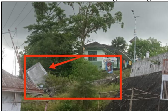
Gambar 2. Kondisi Bangunan TPI Haumeniana Akibat Longsor
